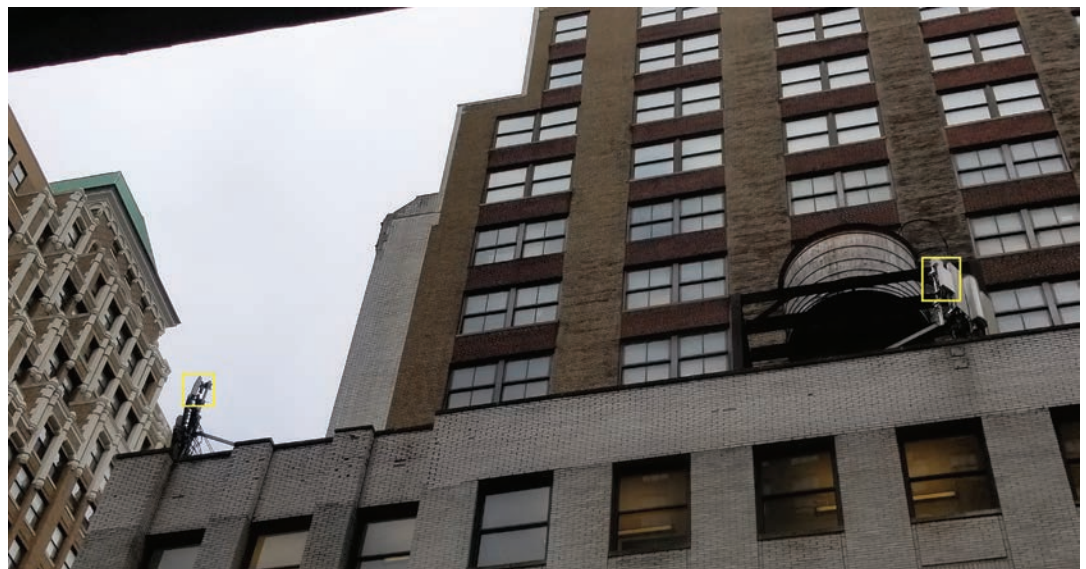
Figure 18. T-Mobile USA 5G Cell Site
